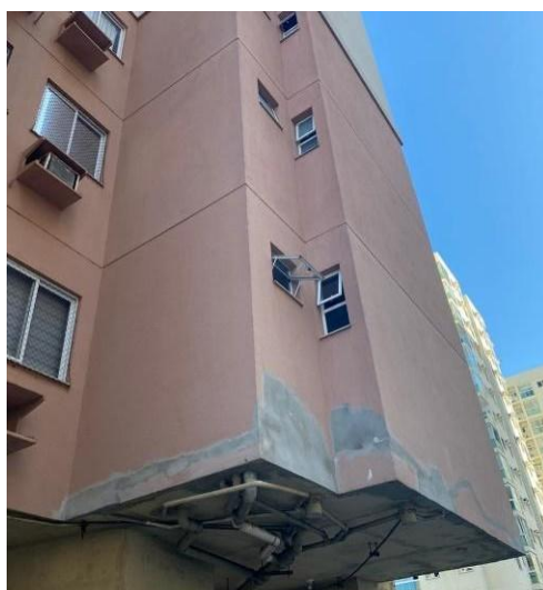
Figura 10: Fachada inferior do edifício com reparos recentes no revestimento
