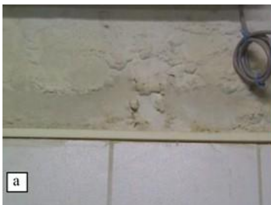
Figura 1: Manifestações de umidade e infiltração em parede interna.
