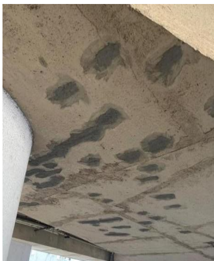
Figura 9: Deslocamentos e reparos pontuais em laje
