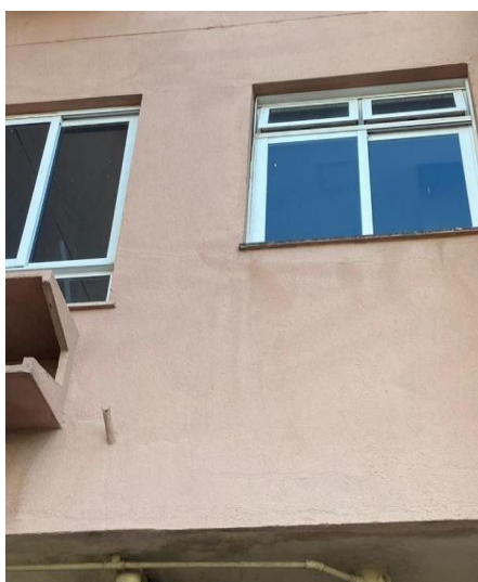
Figura 8: Fachada do edifício com manchas de umidade sob janelas
