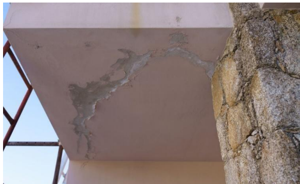
Figura 3: Infiltrações em estruturas de concreto.
