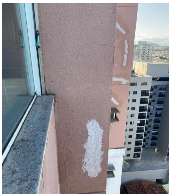
Figura 5: Fissuras relacionadas a movimentações térmicas e estruturais.
