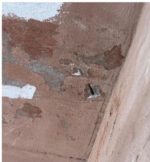
Figura 7: Área com deslocamento de reboco e sinais de infiltração
