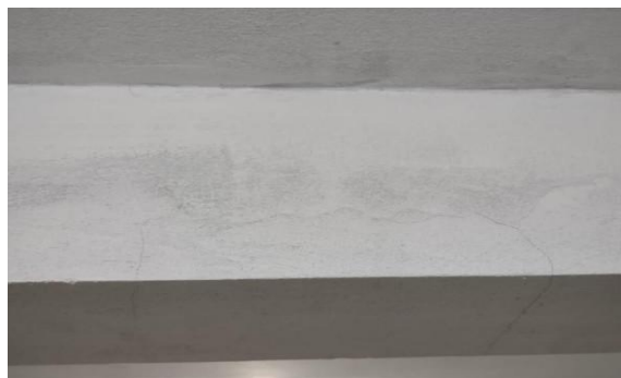
Figura 2: Fissuras e trincas em elemento de concreto armado (viga).
