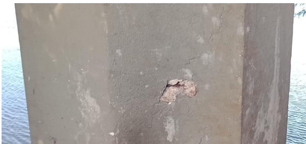
Imagem 5 – Armadura exposta na ponte Rio Cricaré
