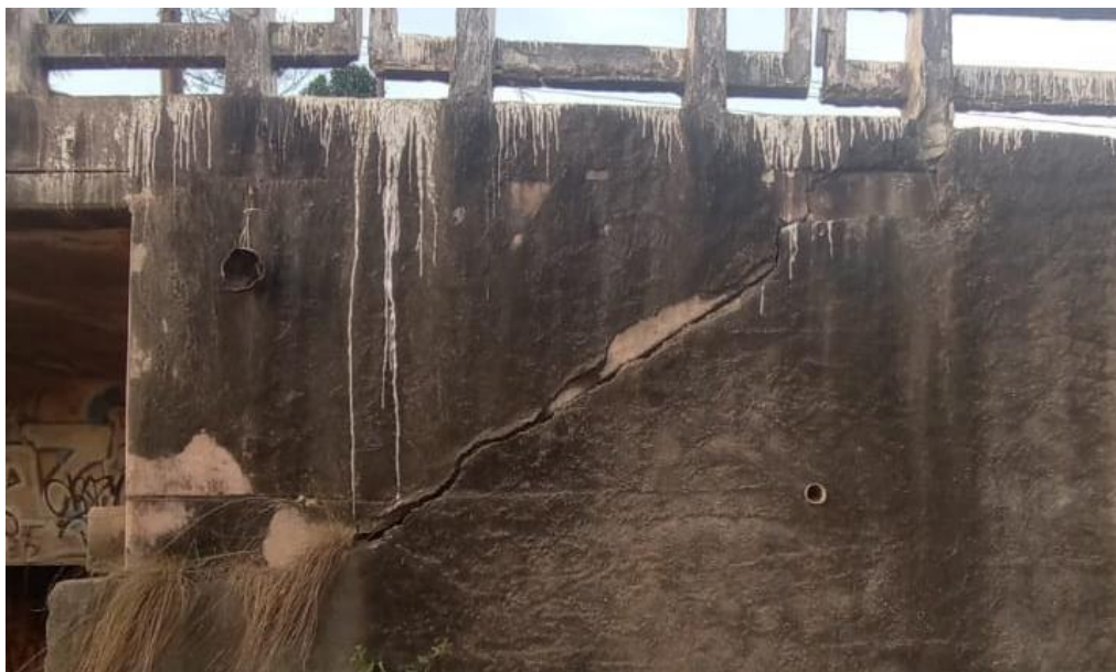
Imagem 8 – Brecha no encontro da ponte Rio Mariricu
