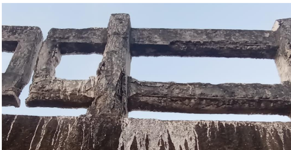
Imagem 6 – Perda de cobrimento e armadura exposta na ponte Rio Mariricu
