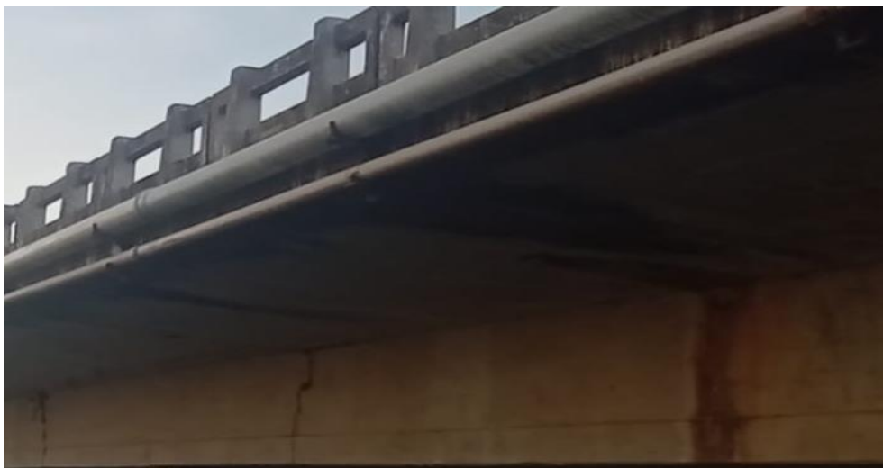
Imagem 7 – Manchas e mofos no concreto na Ponte Rio Mariricu
