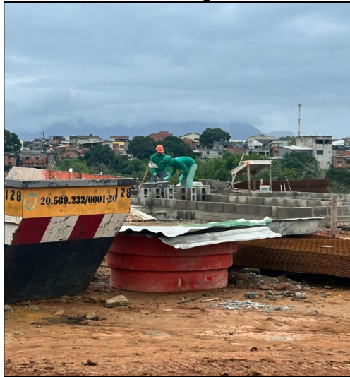
Figura 5: Operário ajustando ferramenta com ausência de superfícies de trabalho adequadas, ambiente desorganizado.
