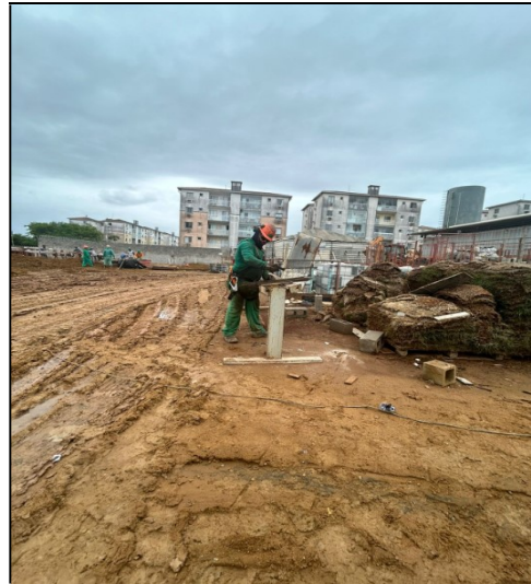
Figura 6: Ambiente de trabalho inadequado, com piso irregular e entulho.
