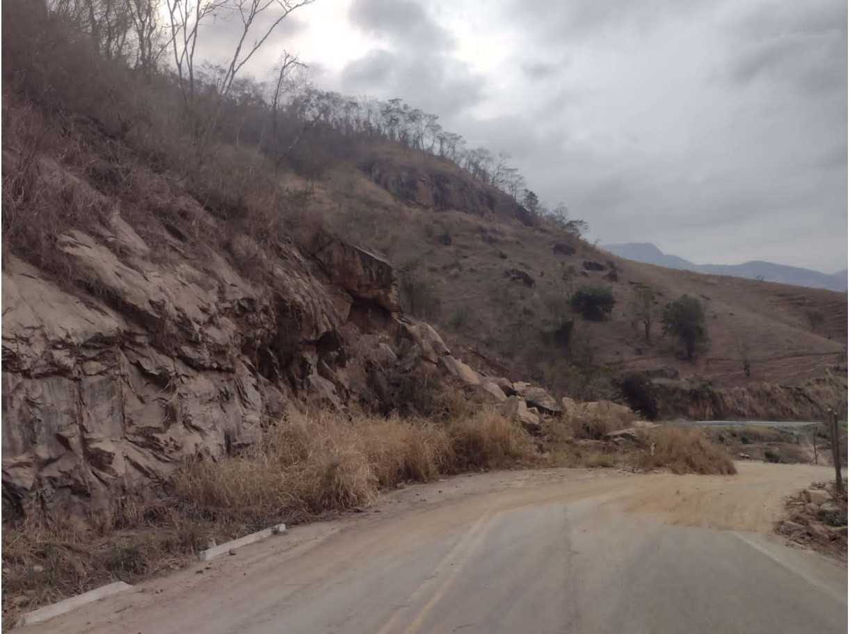
Figura 3 – Trecho Serra da Aliança – Deslizamento de encosta
