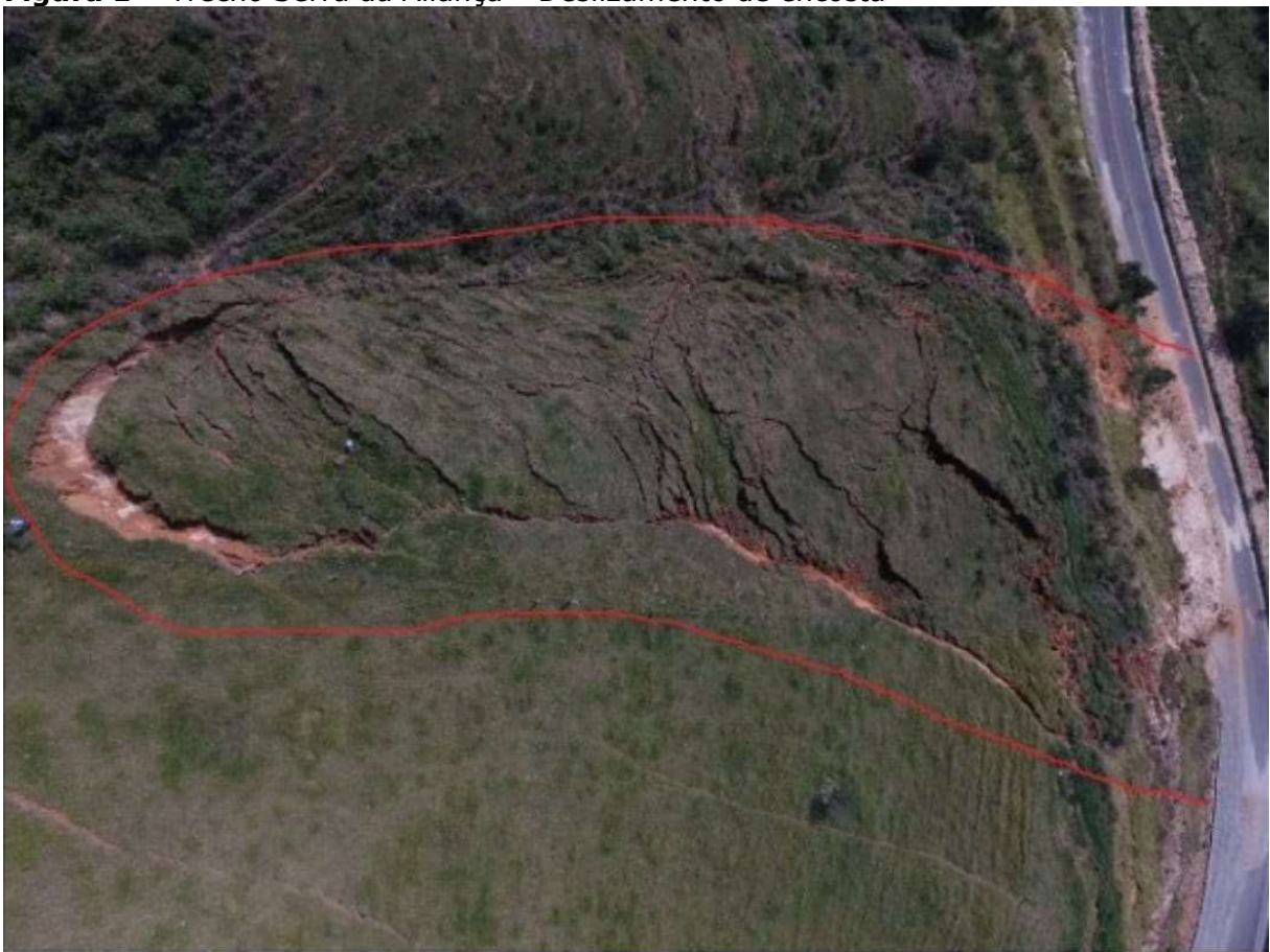
Figura 1 – Trecho Serra da Aliança – Deslizamento de encosta
