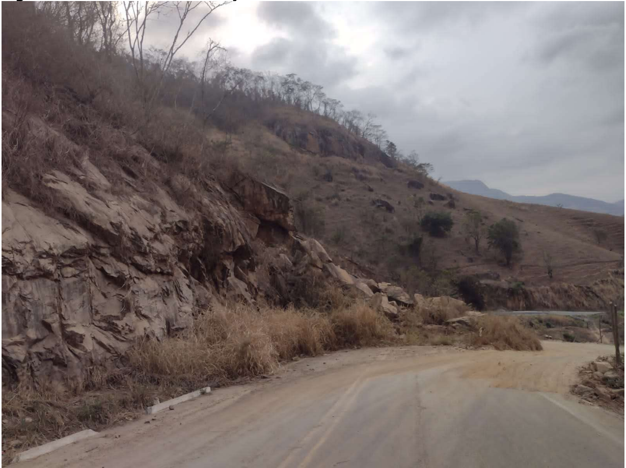
Figura 3 – Trecho Serra da Aliança – Deslizamento de encosta
