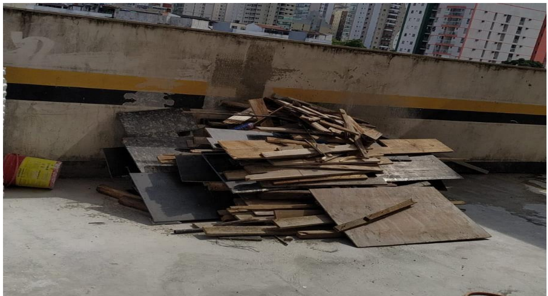
Figura 5 – Ausência de organização (OBRA 2)
