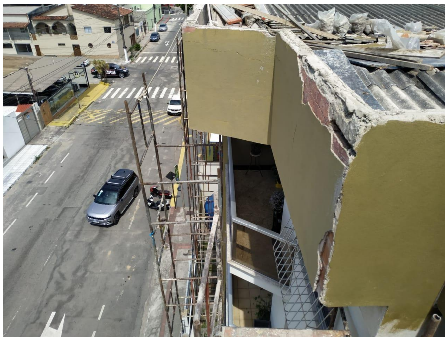
Figura 3 – Ausência de ancoragem do andaime – (OBRA 1)
