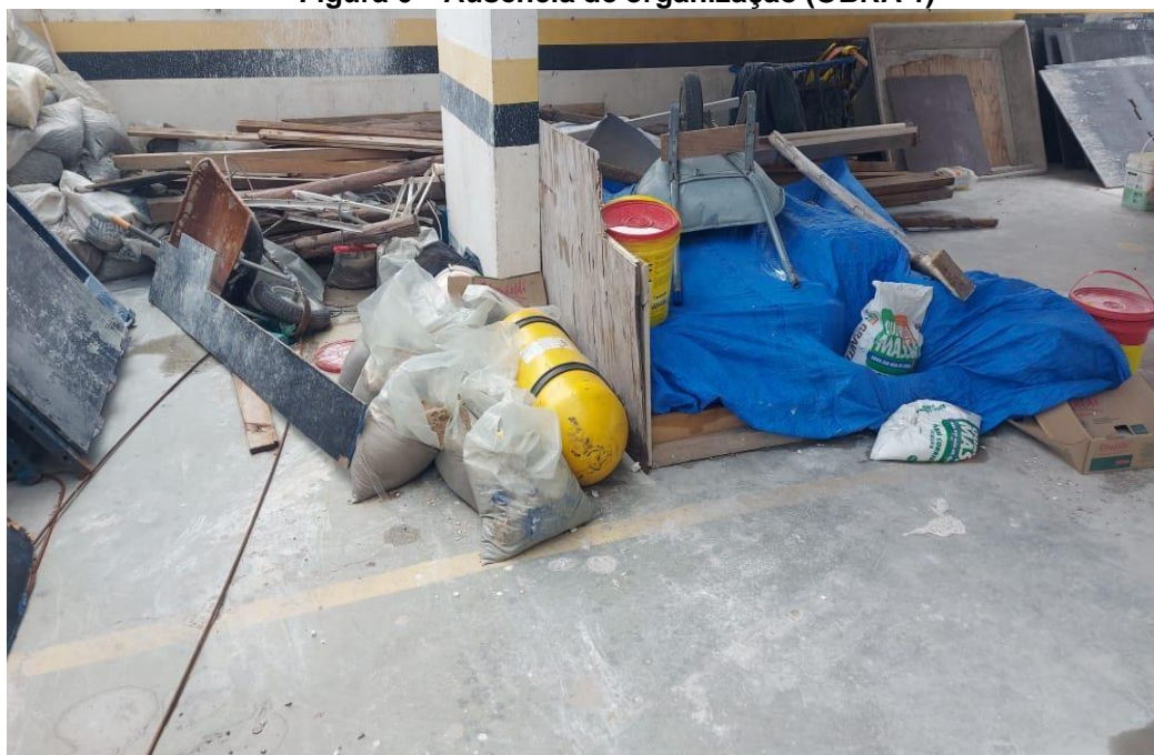
Figura 6 – Ausência de organização (OBRA 1)
