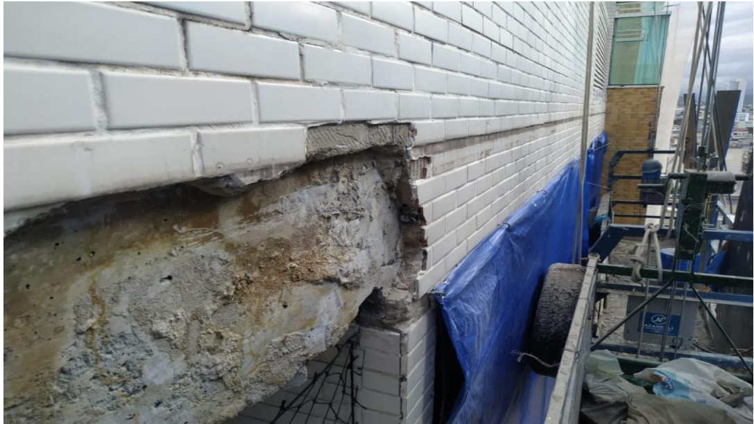
Figura 4 – Ausência de proteção contra queda – (OBRA 2)
