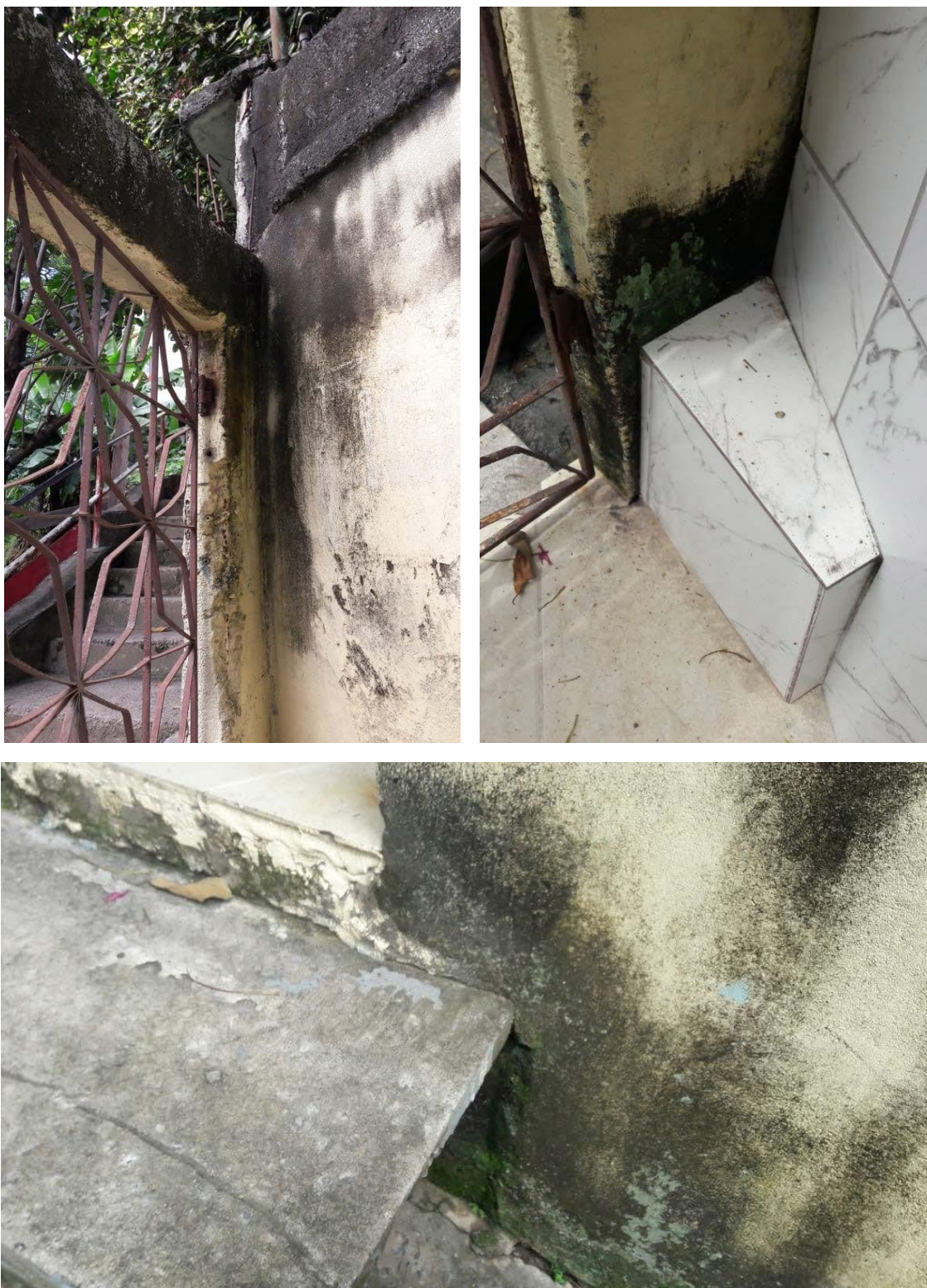
Figuras 12,13 e 14 – Manchas e mofos em áreas externas
