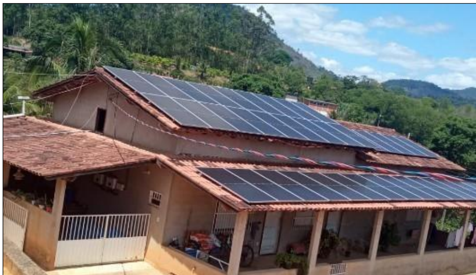
Figura 5 – Imagem da residência após a implantação das placas de energia solar
