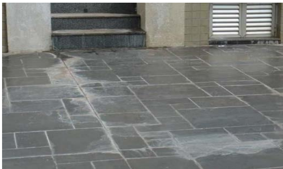
Figura 3 – Pisos com eflorescência
