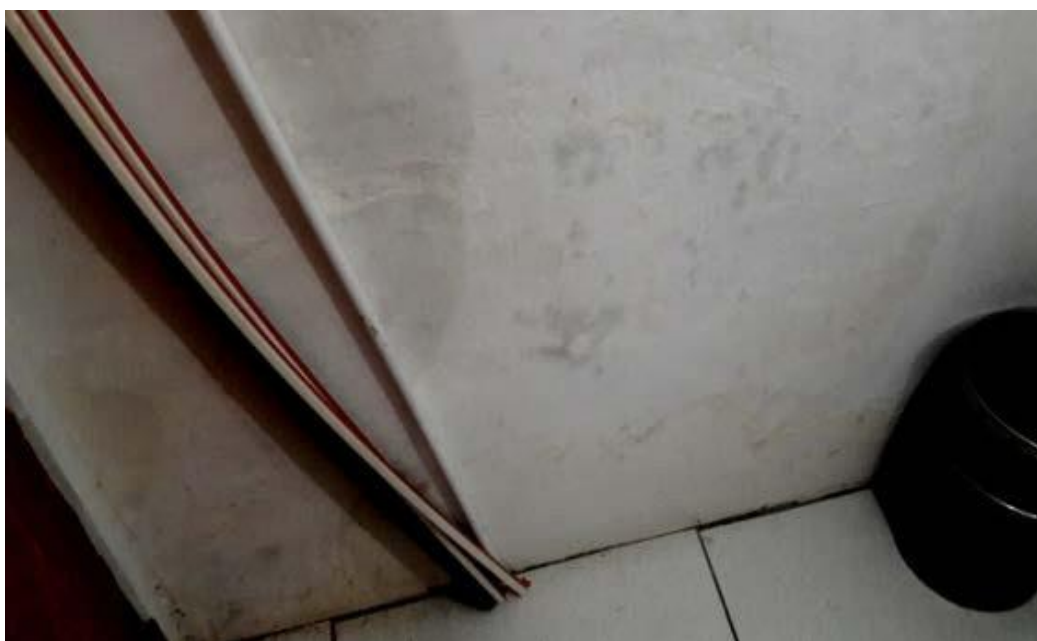
Figura 18 – Manchas na parede em contato com banheiro
