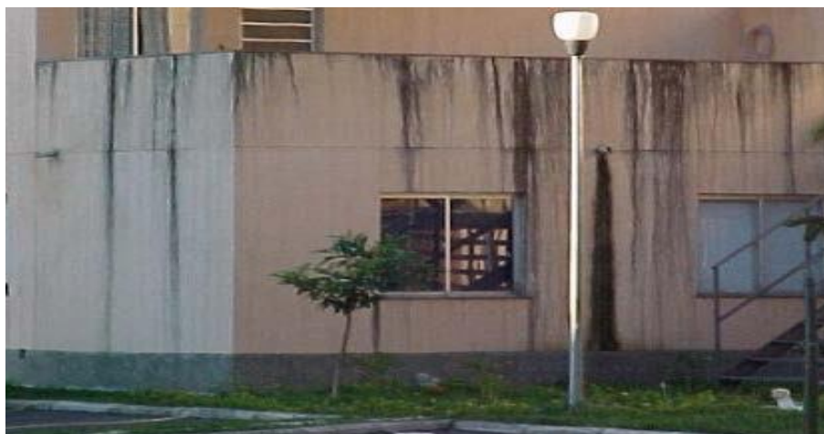
Figura 1 – Manchas presentes numa edificação
