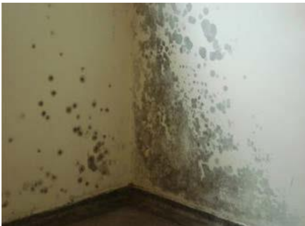
Figura 2 – Parede com mofo
