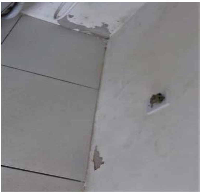
Figura 15 – Desagregamento tintas na parede da varanda
