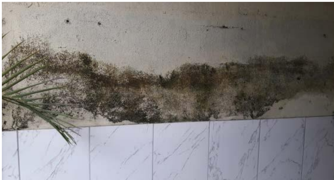
Figura 20 – Mofo em parede do segundo pavimento
