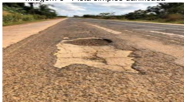
Imagem 6 - Pista simples danificada
