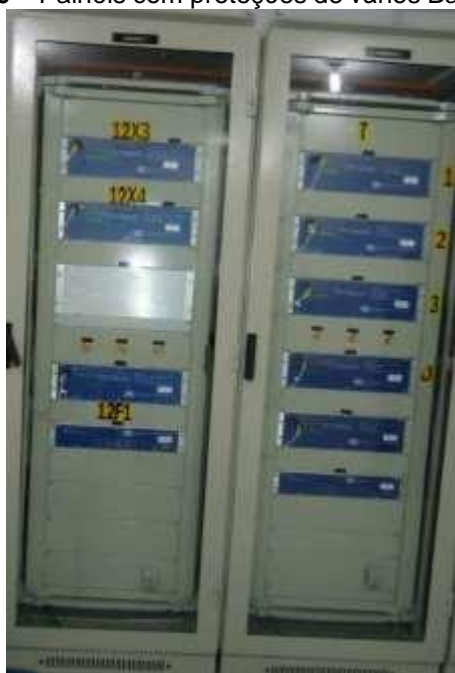
Figura 10 – Painéis com proteções de vários Bays
