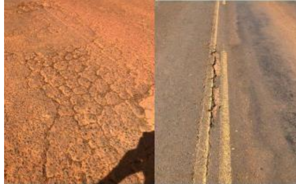
Imagem 3 -Tricas tipo jacaré e trinca longitudinal
