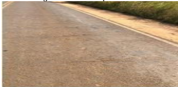
Imagem 5 - Exsudação do asfalto
