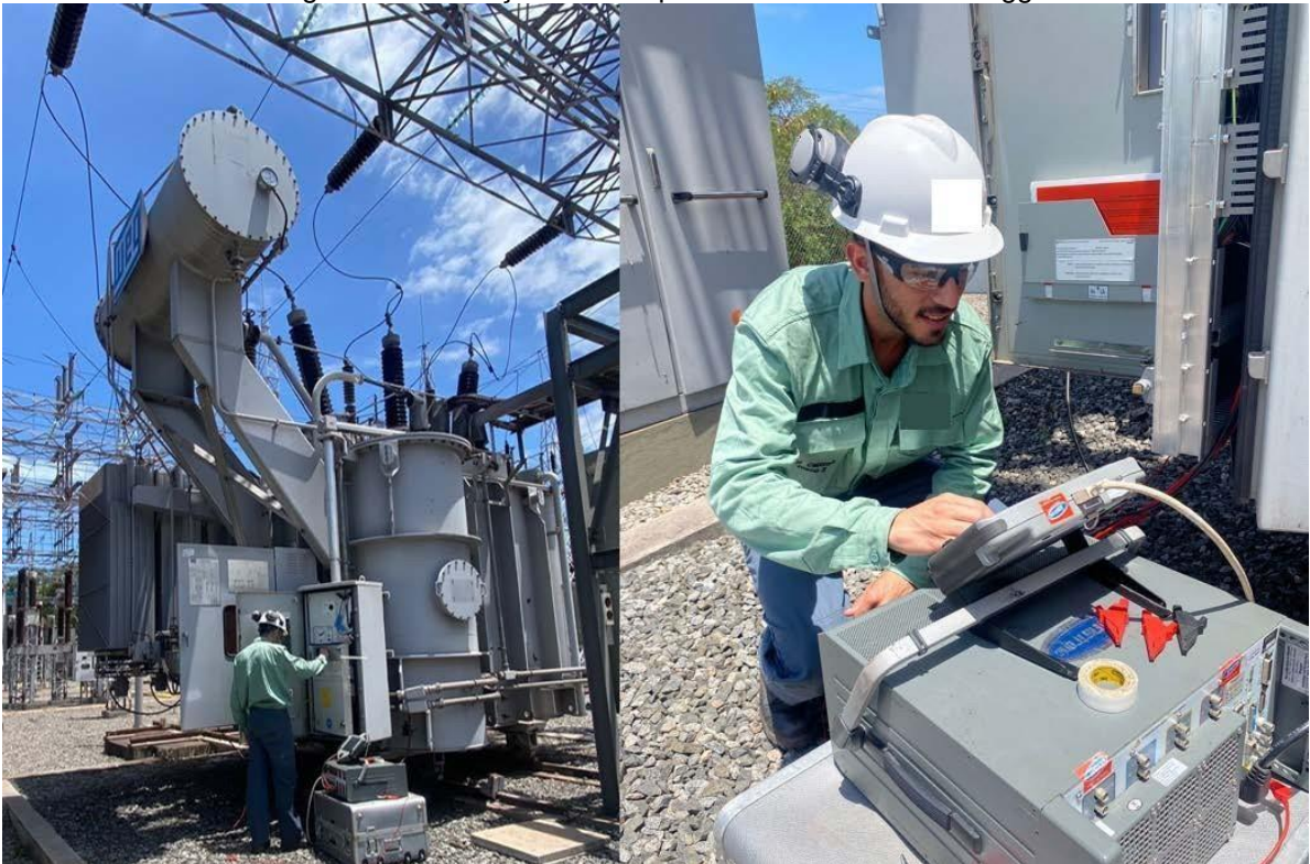
Figura 7 - Simulação em campo com mala de testes Megger
