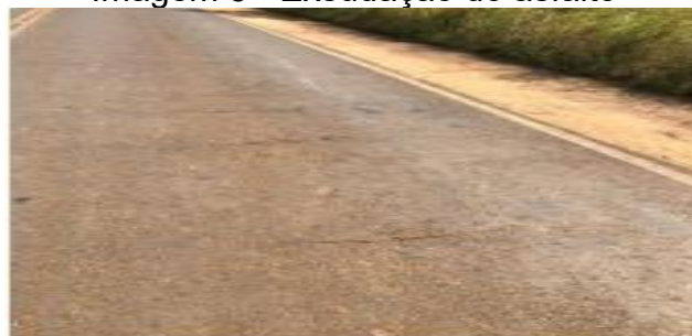
Imagem 5 - Exsudação do asfalto
