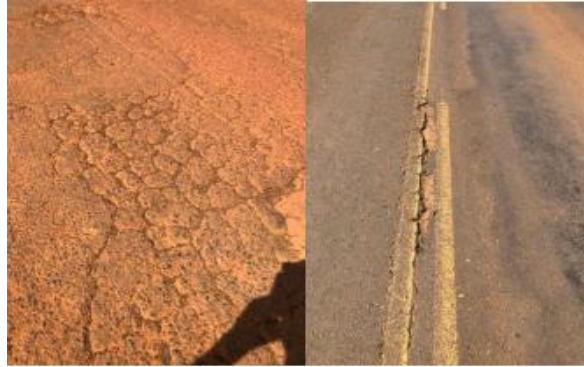
Imagem 3 -Tricas tipo jacaré e trinca longitudinal
