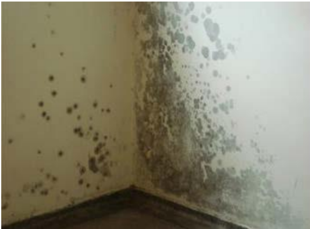
Figura 2 – Parede com mofo
