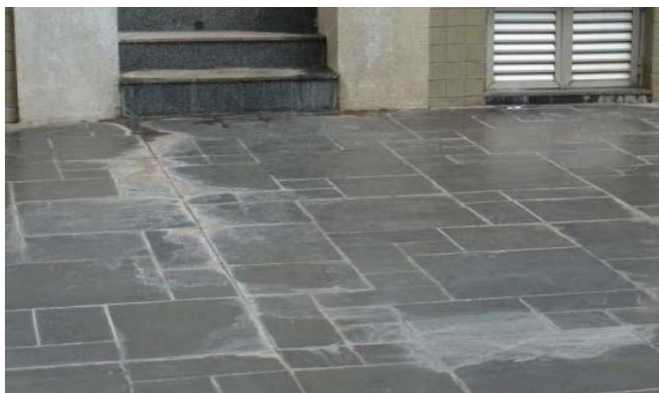
Figura 3 – Pisos com eflorescência
