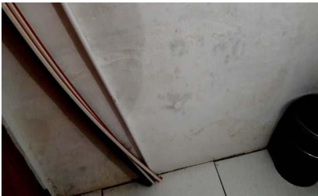
Figura 18 – Manchas na parede em contato com banheiro
