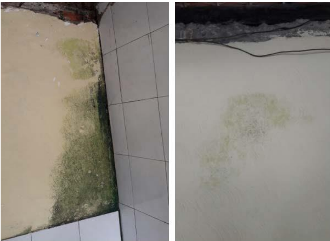
Figuras 21 e 22 – Mofo em parede do segundo pavimento
