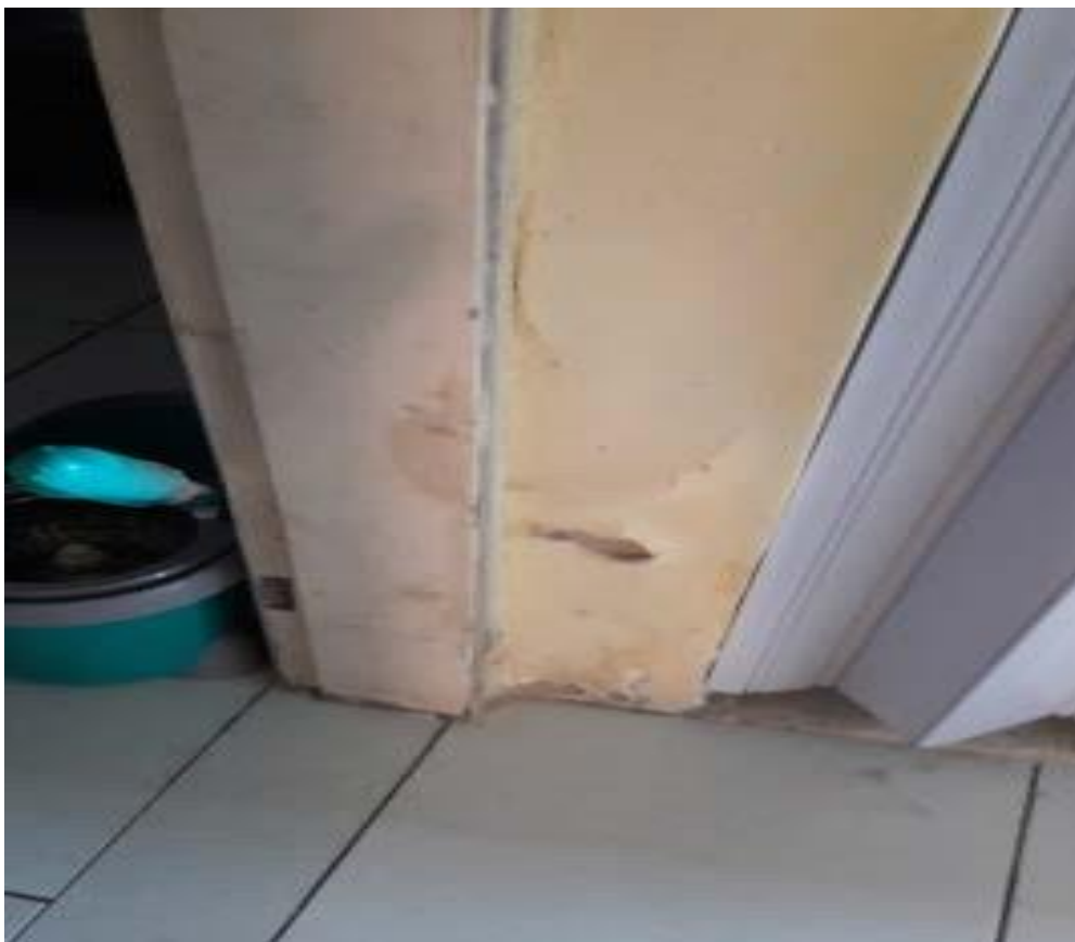
Figura 16 – Desagregamento tintas na parede em contato com banheiro
