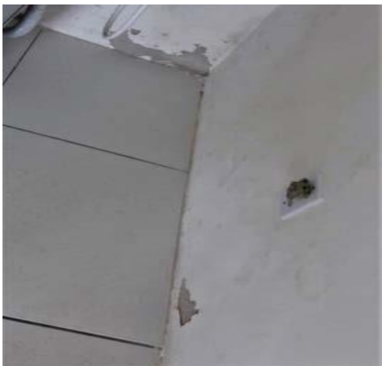
Figura 15 – Desagregamento tintas na parede da varanda
