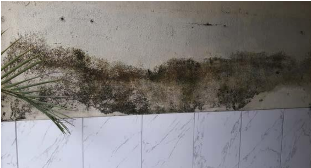
Figura 20 – Mofo em parede do segundo pavimento
