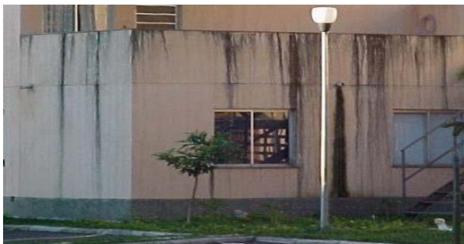
Figura 1 – Manchas presentes numa edificação
