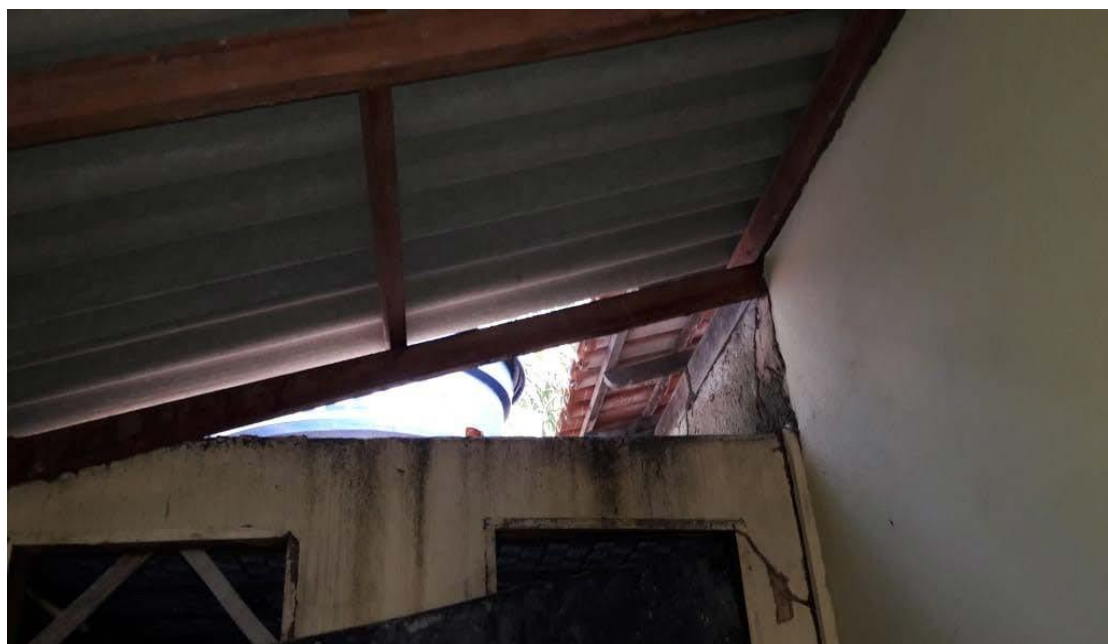
Figura 19 – Fissuras na parede do banheiro inativado do segundo pavimento
