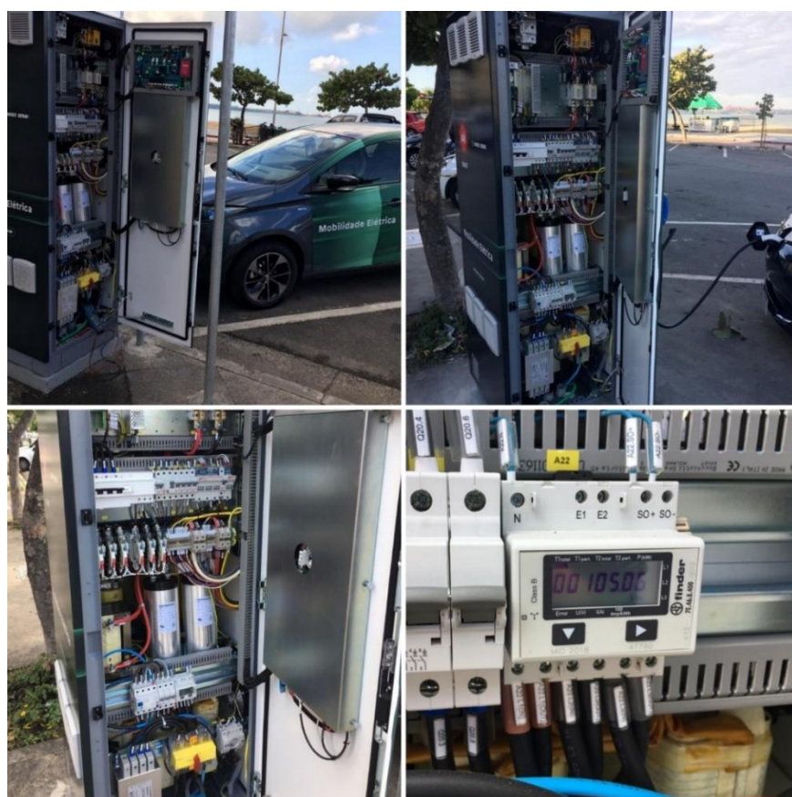
Figura 6 - Eletroposto na praia de Camburi, em Vitória/ES. Fonte: Própria.
