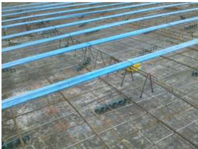
Imagem 12 - Cabos apoiados sobre treliças metálicas.
