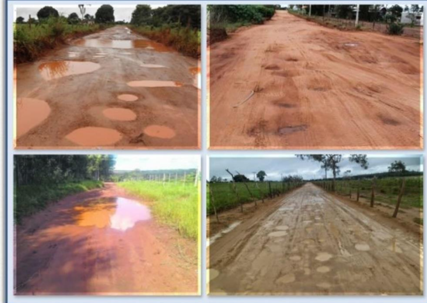
Figura 2 - Vias vicinais em péssimas condições em períodos chuvosos
