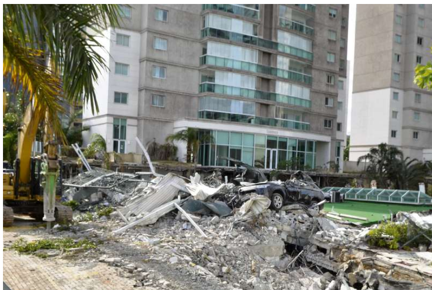
Figura 18: Área de lazer do Condomínio Grand Parc Residencial Resort desabada
