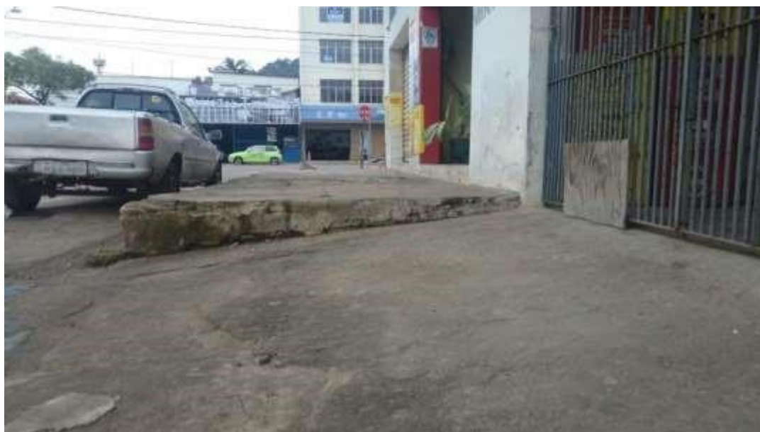
Figura 3: Desnível em calçada da Grande Vitória.
