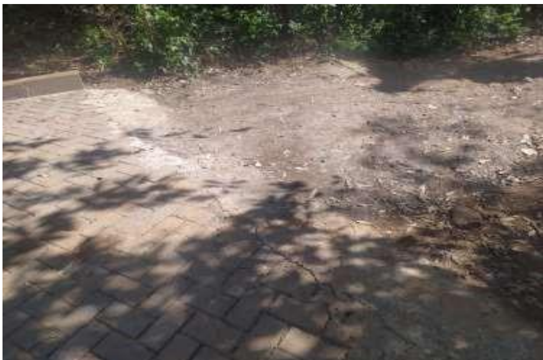
Figura 10: Divisão entre a parte com pavimentação e a parte sem pavimentação
