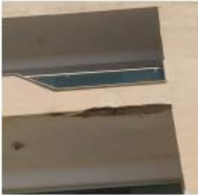
Deslocamento e corrosão
