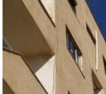
Mancha e fissura na fachada do edifício
