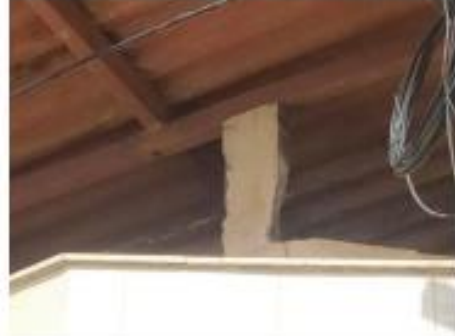
Viga com ferragem exposta e deslocamento
