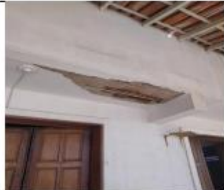
Deslocamento com ferragem exposta
