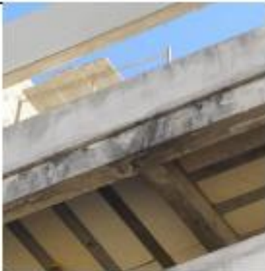
Viga com infiltração, mancha, fissura e corrosão
