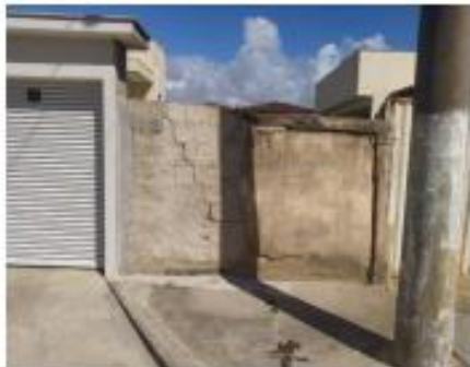
Alvenaria de fachada com rachadura e risco de queda
