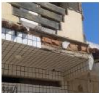
Fachada em degradação avançada
