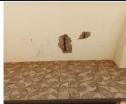
Viga em estado corrosivo o ocasionando deslocamento
