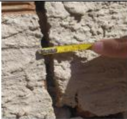
Rachadura com mais de 1cm
