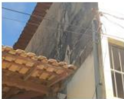
Mancha, eflorescência e bolor na alvenaria
