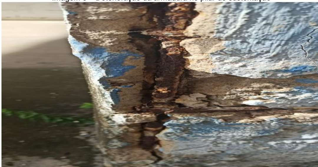
Imagem 9 – Deterioração da armadura no pilar de sustentação
