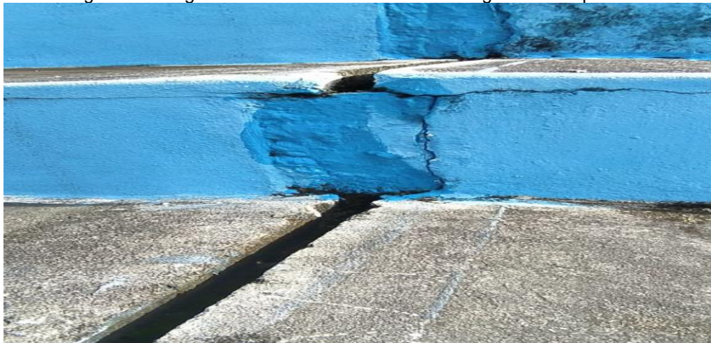
Imagem 5 – Surgimento de trincas e fissuras nos degraus da arquibancada
