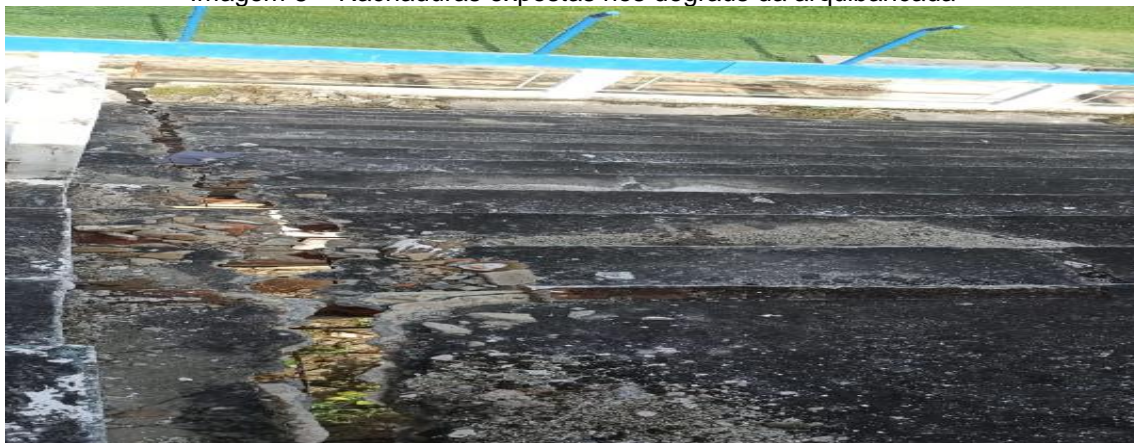
Imagem 8 – Rachaduras expostas nos degraus da arquibancada
