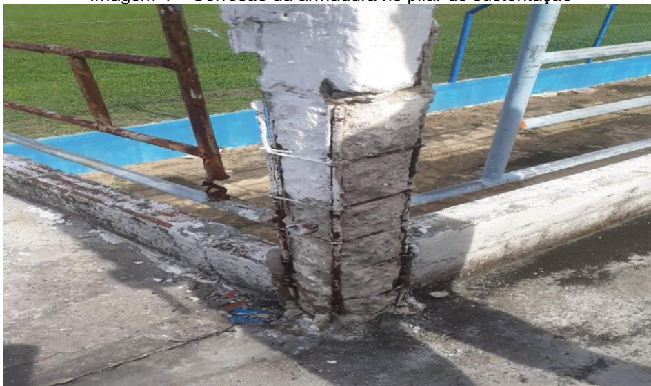
Imagem 4 – Corrosão da armadura no pilar de sustentação
