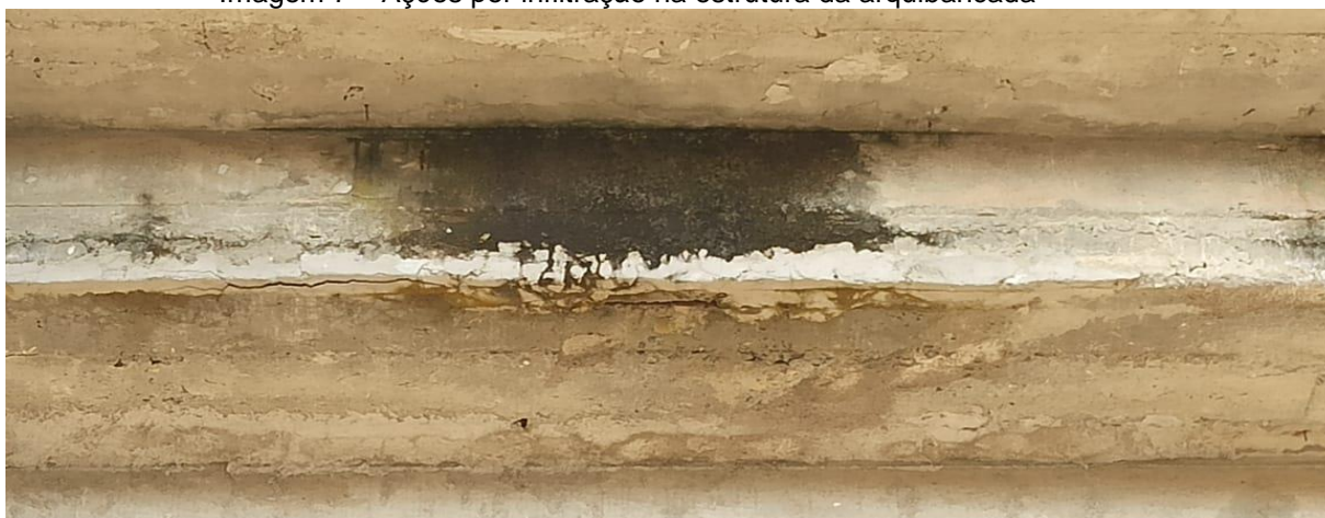
Imagem 7 – Ações por infiltração na estrutura da arquibancada
