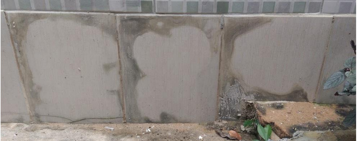
Imagem 4: Manchas e mudança de cor dos revestimentos
