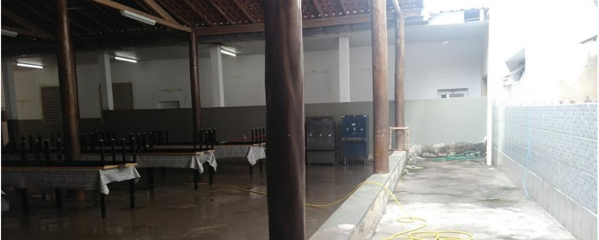
Imagem 1: Local do objeto de estudo com região aberta sujeita a intempéries e piso sem revestimento
