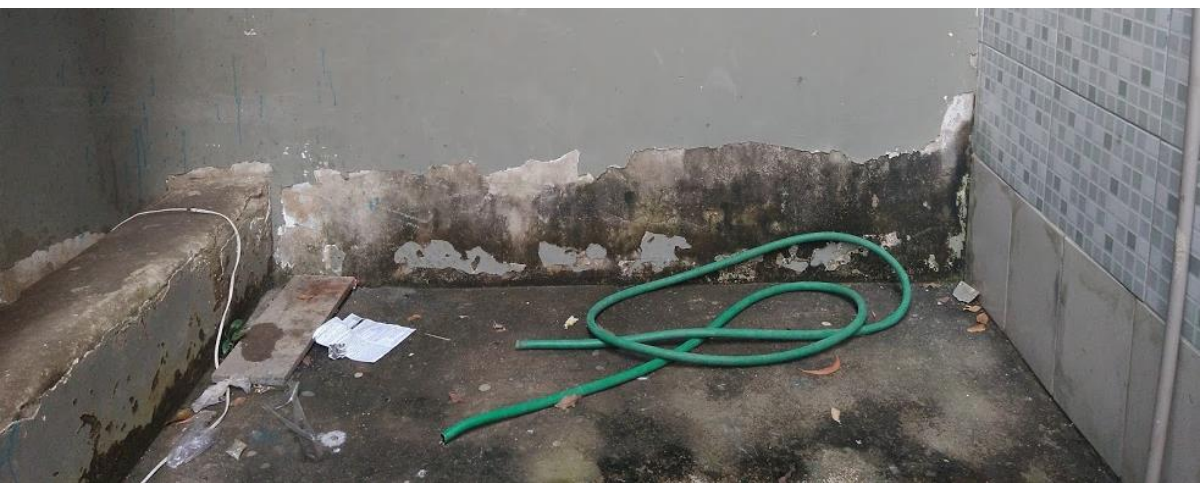
Imagem 3: Descascamento da tinta na parte inferior da parede
