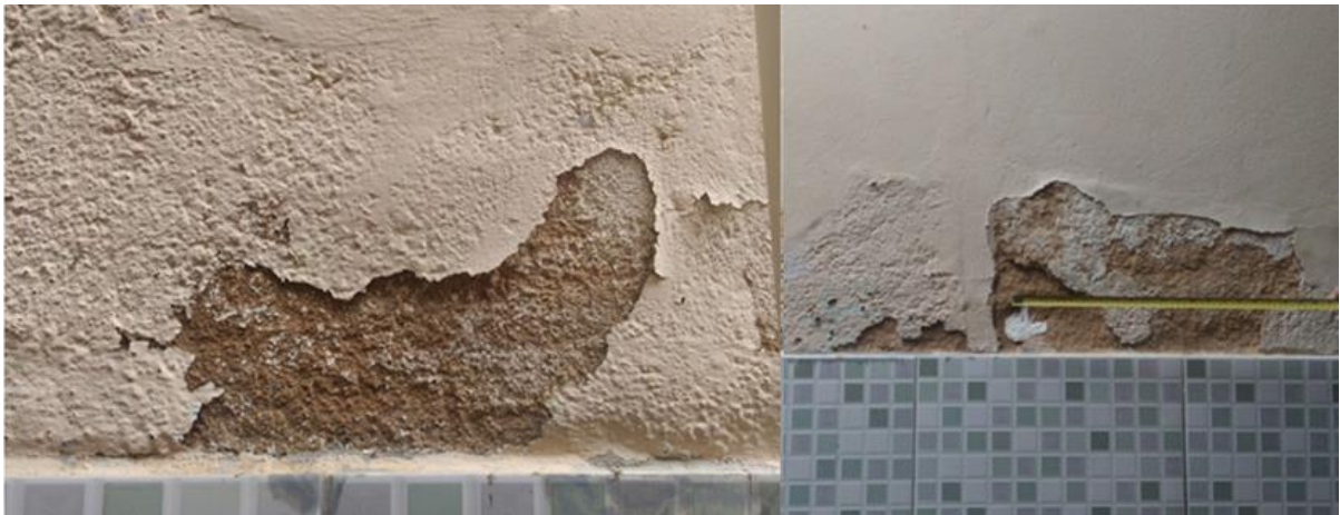
Imagem 2: Apodrecimento e descolamentos do revestimento
