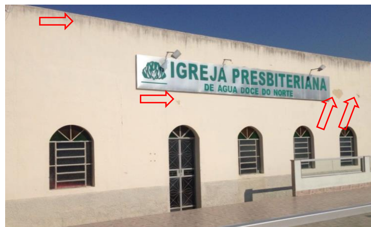
Fig. 02 – Patologias fachada da Igreja Presbiteriana. Fonte: Acervo dos autores, 2016.
