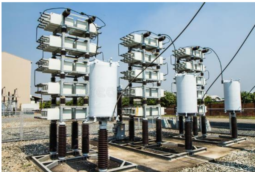
Figura 4 – Banco de Capacitores
