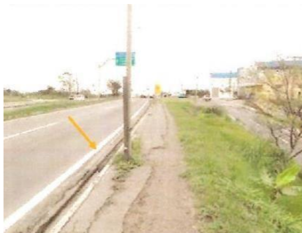
Figura 04: Demonstração da ausência de acostamento no km 264 e imediações - sentido decrescente. Fonte: Relatório Técnico de Segurança Viária - PRF (2016)
