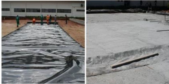
Figura 6 – Implantação da geomembrana no estacionamento do Centro Tecnológico de Hidráulica da Universidade de São Paulo – USP. Fonte: Centro Tecnológico de Hidráulica da USP, 2009.
