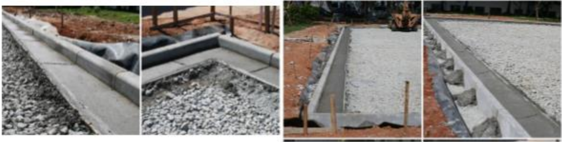
Figura 8 – Implantação das sarjetas no estacionamento do Centro Tecnológico de Hidráulica da Universidade de São Paulo – USP.
