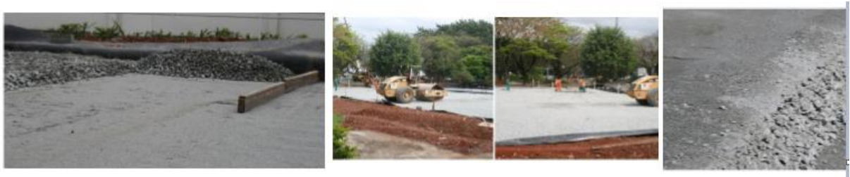
Figura 7 – Implantação da pedra 3 no estacionamento do Centro Tecnológico de Hidráulica da Universidade de São Paulo – USP.
