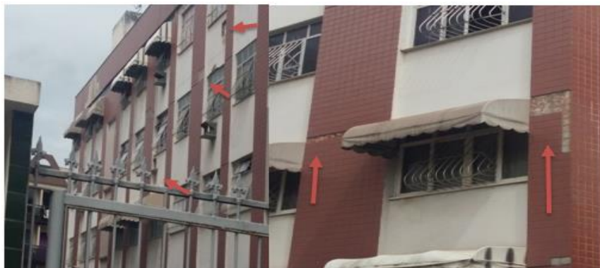
Figura 13 – Vista da fachada do ed. 06, observa-se descolamentos de placas cerâmicas
