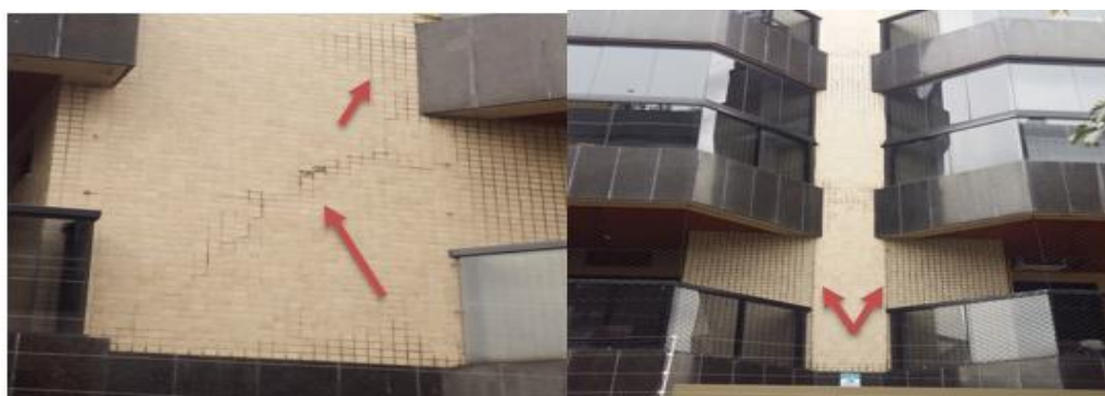
Figura 12 – Vista da fachada do ed. 05, observa-se trincas e Deterioração das juntas
