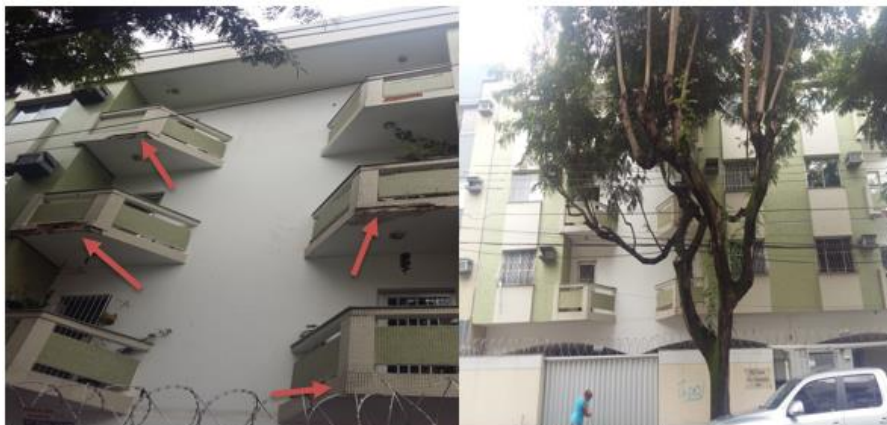
Figura 9 – Fachada do ed. 02, encontra- se descolamento de placas e Eflorescências
