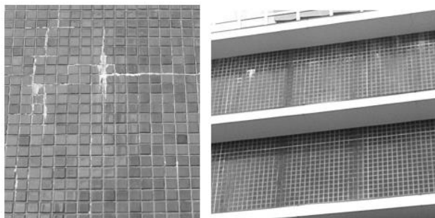
Figura 2 - Eflorescências em revestimentos cerâmicos de fachadas
