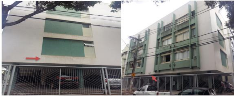
Figura 10 – Fachada do ed. 03, encontra se descolamento de placas e Manchamento
