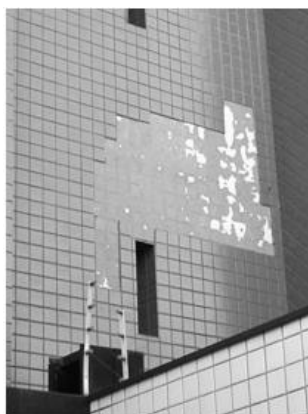
Figura 3 - Descolamento de placas cerâmicas nos primeiros pavimentos de um edifício
