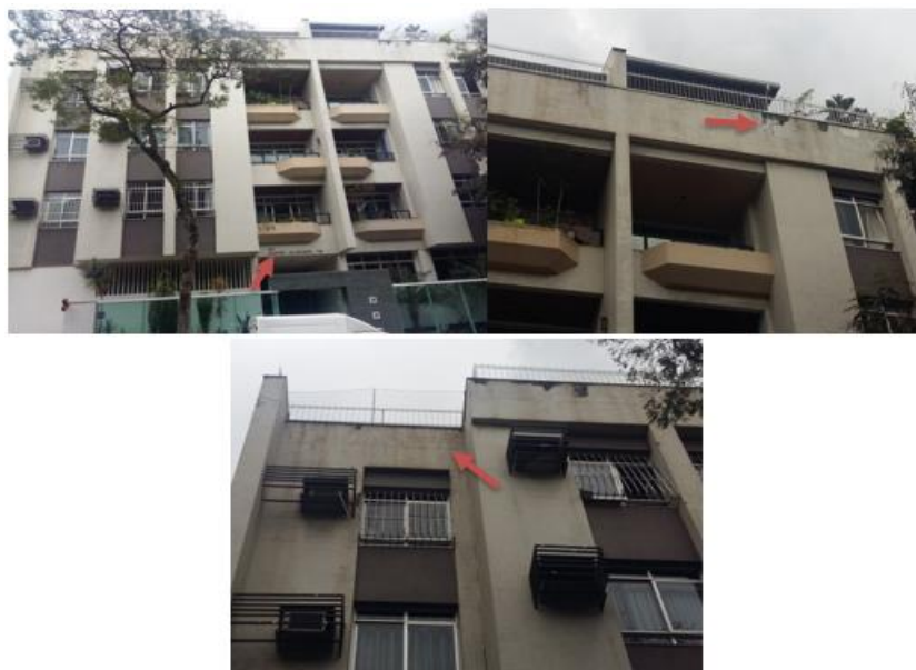
Figura 11 – Vista da fachada do ed. 04, observa-se descolamento cerâmico e manchamento
