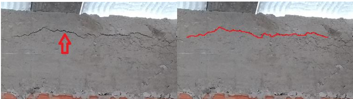
Figura 14: Fissura em viga, Obra 1 Fonte: Próprio Autor (2017)
