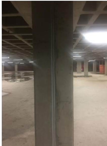
Figura 13: Pilar com fissura ativa tratado com junta de dilatação Fonte: UNIONTECH (2016)
