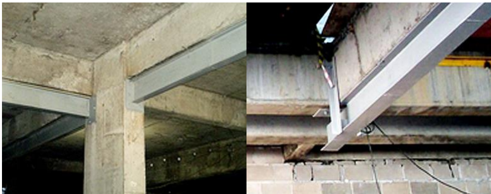
Figura 15: Reforço metálico em vigas Fonte: Global Groups (2009)
