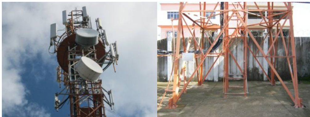
Vista das antenas instaladas na torre de h=30\text{m} .
