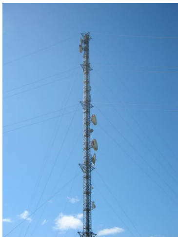
Figura 1 – Torre metálica treliçada e estaiada. Fonte – Levantamento técnico, município de Sooretama/ES
