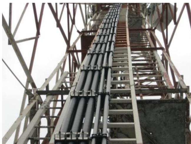
Figura 26 – Cabos de RF na torre Fonte – Levantamento técnico
