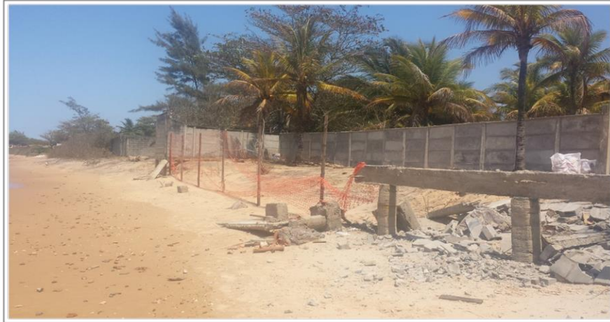
Figura 10 – Foto atual, obra de recuo de limite de propriedade na orla de Ponta da Fruta 10/2017
