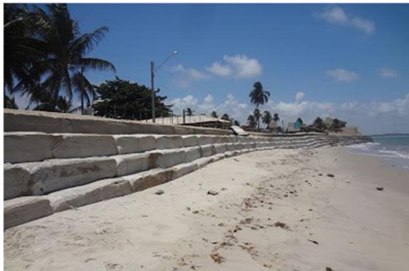
Figura 2 – Exemplo de contenção com uso de Gabião Fonte: Google Earth
