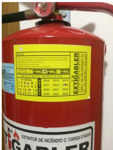
Figura 9 – Extintor fora do prazo de validade Fonte: Autoria própria
