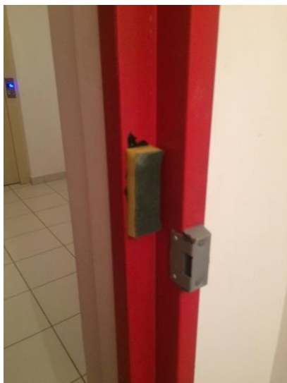
Figura 4 – Esponja fixada na porta corta-fogo Fonte: Autoria própria
