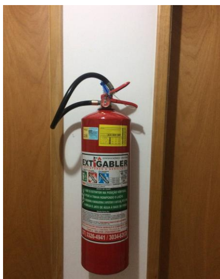
Figura 14 – Extintor sem placa de sinalização de equipamento Fonte: Autoria própria
