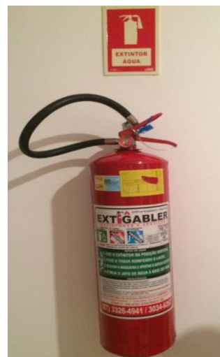
Figura 10 – Extintor com etiqueta danificada Fonte: Autoria própria
