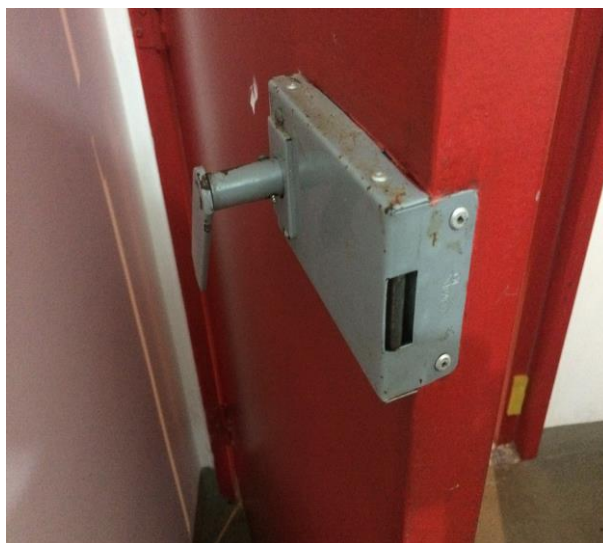
Figura 5 – Maçaneta da porta corta-fogo quebrada Fonte: Autoria própria
