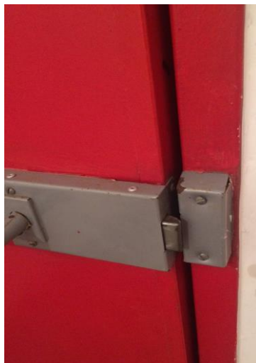
Figura 6 – Porta corta-fogo sem fechamento automático Fonte: Autoria própria
